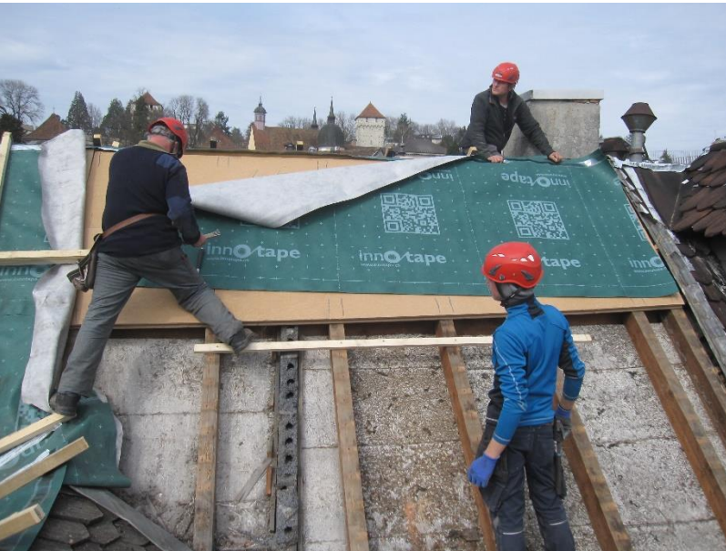
v.l.n.r. Hans Geiser, Kole Milici und Kevin Primoschitz in Aktion bei einer Dachsanierung in Luzern.
