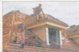
Steildach mit arbeitsaufwändigen Erkerfenstern.
